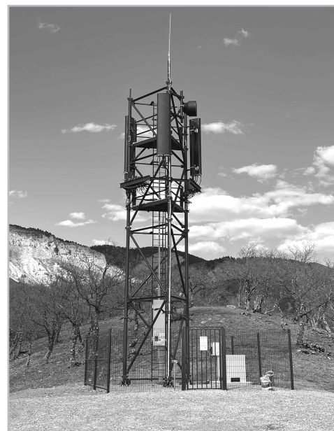
Antenne 4G installée à Serre du Dauphin
